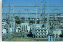
周囲の景色も変わり、構内の設備も変わりましたが、鉄塔が重なり合って立ち並ぶ様子は、昔の姿を留めています。 (武蔵境交流変電所)
